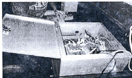
Fig. 12 Fotografía de la caja metálica del equipo de control.
