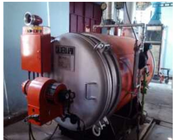
Fig. 1 Aislantes colocados sobre la superficie de la caldera y el ducto de vapor.
