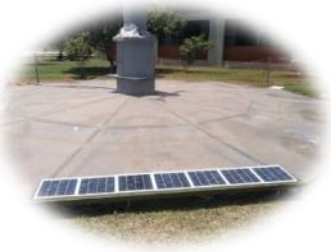
Fig. 3.26 Subsistema fotovoltaico (a) en la periferia.
