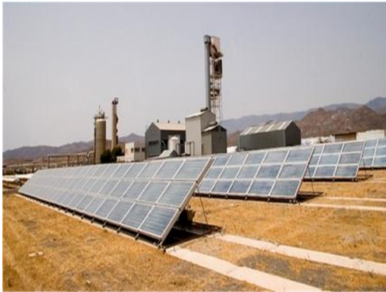
Fig. 21 Campo de captadores solares estáticos (500 m 2 ) del Proyecto AQUASOL.
