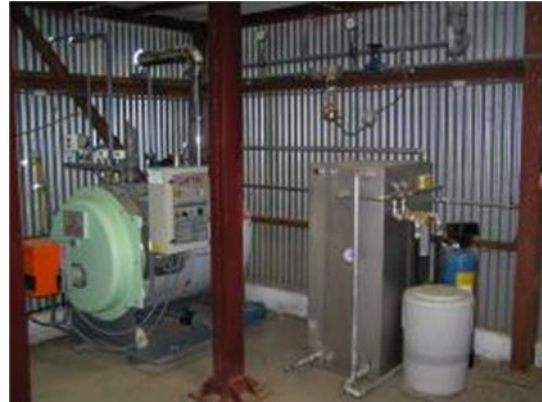
Fig. 24 Sistema de caldera de gas del Proyecto AQUASOL.
