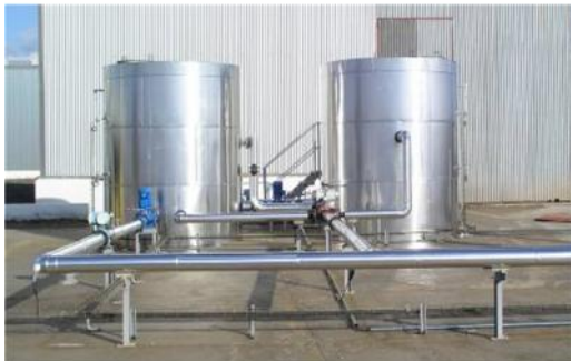
Fig. 23 Vista frontal de los tanques de almacenamiento del proyecto AQUASOL.
