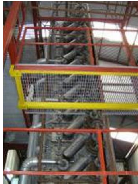
Fig. 20 Vista frontal de la planta de destilación multiefecto de la PSA.
