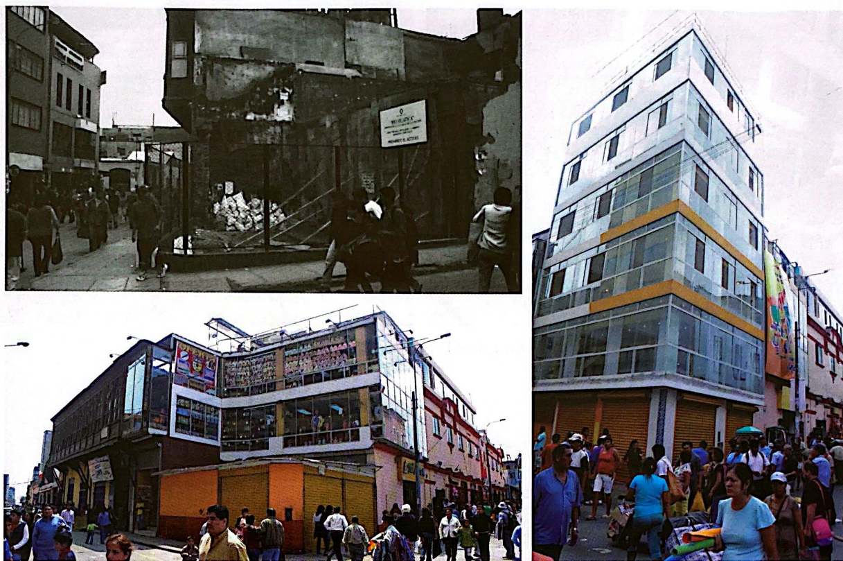
Figura 9. Evolución desapercibida por las autoridades de la esquina de los jirones Cusco con Andahuaylas en Mesa Redonda: a. Después del incendio de 2001 con el canal Huatica salido a la luz y el cartel del INC (2002). b. Nuevamente sobreconstruido con un primer piso de una galería informal (2008). c. Un edificio de cinco plantas informalmente levantado encima del patrimonio intangible (2013).
