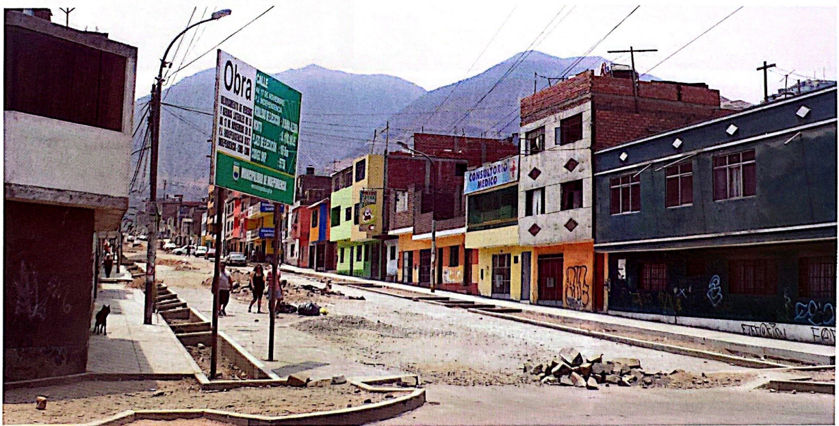
Figura 13. Actuales trabajos de pavimentación y renovación del espacio público de la avenida 17 de Noviembre, sin tener en cuenta las propuestas de la población ni las exigencias de la pendiente pronunciada de la zona.
