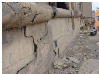
Figura 6. Detalle del alfeizar de la torre campanario de la Iglesia Matriz de Jauja, en el proceso de diagnóstico para elaborar el expediente técnico. Archivo fotográfico de Armando Chipana, 2009.
