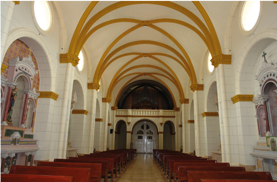
Figura 4. Detalle de la nave de Iglesia Matriz de Jauja antes de su intervención. Archivo fotográfico del autor, 2009.
