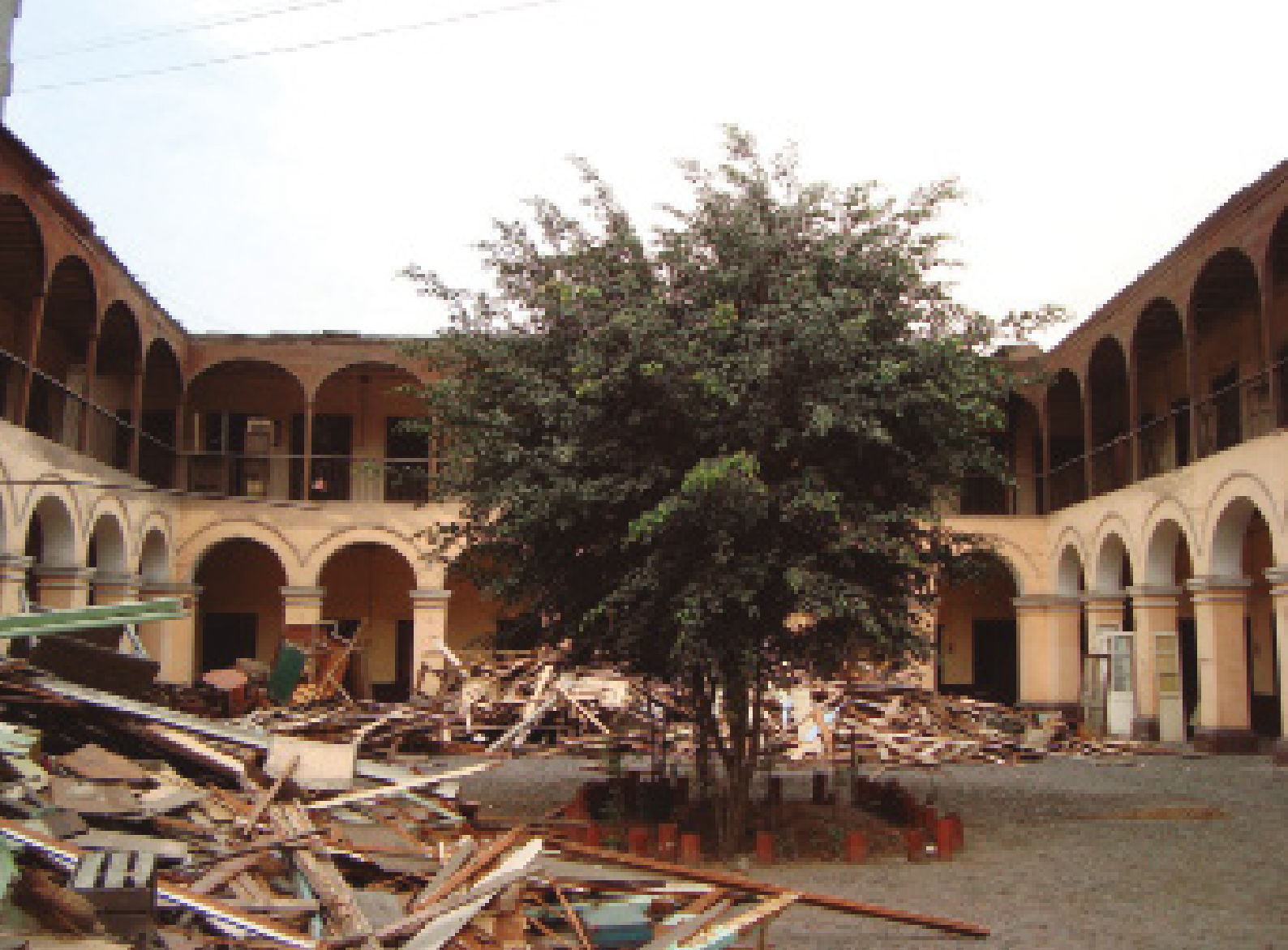
Figura 5. Desmontaje de estructuras de madera; se pueden ver las puertas retiradas de su lugar. Archivo del arquitecto Aldo Lértora, 2010.
