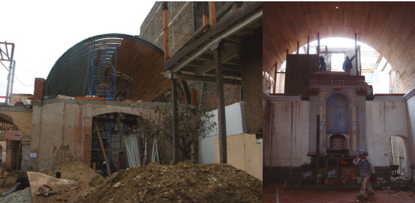
Figura 12. Cerchas metálicas colocadas en la bóveda de la capilla. Archivo del arquitecto Aldo Lértora, 2011.
