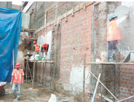
Figura 8: Colocación parcial de mallas de polímero en uno de los muros de ladrillo del primer piso. Archivo del arquitecto Aldo Lértora, 2010.
