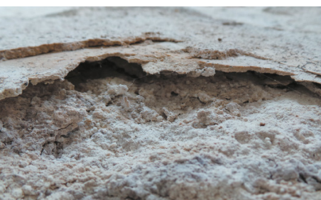
Figura 7. Cristalización de sales y arenización del soporte pétreo bajo el estrato de estuco. Archivo fotográfico de las autoras, 2018.
