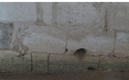
Figura 5. Degradación del estuco y del soporte pétreo en la franja baja del muro afectado por las sales. Archivo fotográfico de las autoras, 2018.
