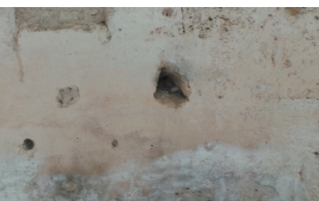
Figura 6. Eflorescencias salinas sobre la superficie del estuco. Archivo fotográfico de las autoras, 2018.
