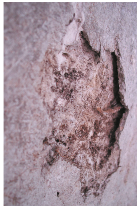
Figura 3. Crecimiento de raíces entre el estuco y el soporte pétreo. Archivo fotográfico de las autoras, 2018.
