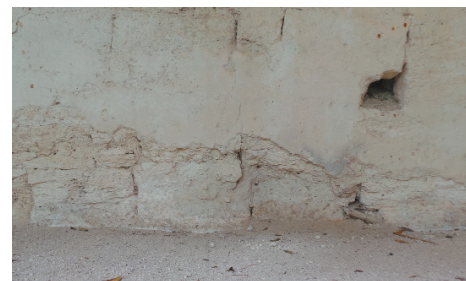
Figura 9. Desprendimiento del estuco y arenización del material pétreo por ciclos de cristalización salina. Archivo fotográfico de las autoras, 2018.
