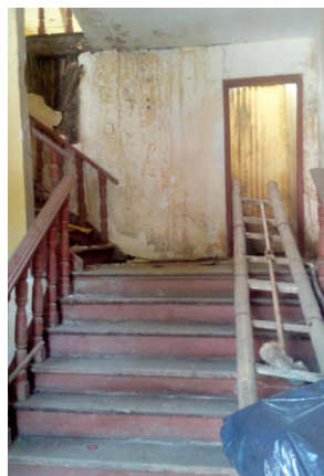
Figura 16. Vista del segundo nivel del Antiguo Cabildo. En Proyecto de Inversión Pública Restauración y Puesta en Valor del Ex Cabildo de Tumbes. Provincia de Tumbes - Departamento de Tumbes , por Municipalidad Provincial de Tumbes, 2014.
