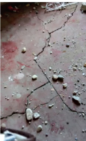
Figura 18. Techo en mal estado. En Proyecto de Inversión Pública Restauración y Puesta en Valor del Ex Cabildo de Tumbes. Provincia de Tumbes - Departamento de Tumbes , por Municipalidad Provincial de Tumbes, 2014.
