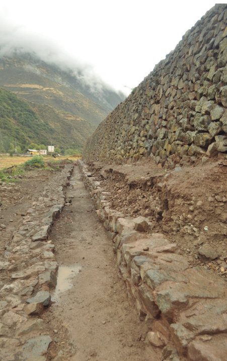
Figuras 19 y 20. Evidencias de ambas estructuras deterioradas a causa de la presión ejercitada por la tierra acumulada sobre ellas. Se realizaron trabajos de corte y eliminación de desmonte para luego atender su recomposición y restitución, previo reticulado y codificación
