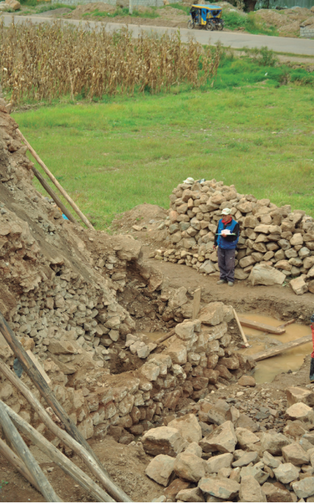
Figura 17. Vista de sectores de andén con problemas de estabilidad
