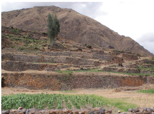
Figura 2. Estado de los andenes antes de la intervención. Vista de tramos alterados, apertura y corte para accesos vehiculares de plataformas de cultivo
