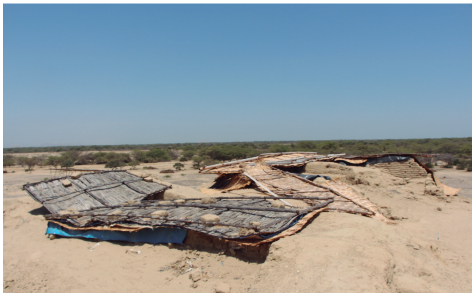
Figura 5. Avanzado desgaste de las coberturas instaladas, colapsadas por falta mantenimiento y desgaste. Estos materiales deleznable fueron reemplazados por planchas de fibra vegetal.
