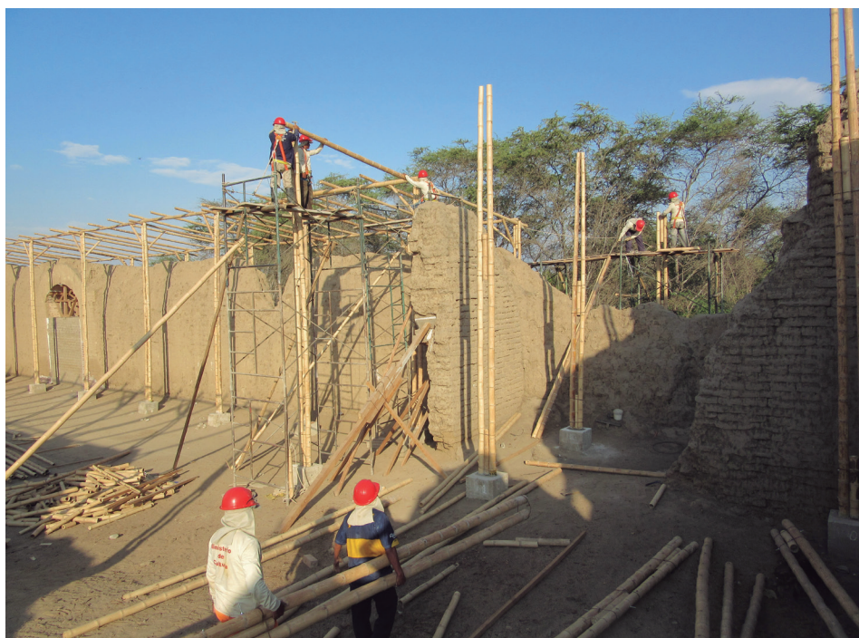
Figura 2. Templo Colonial Túcume Viejo: instalación de coberturas sobre los muros que aún se mantienen en pie. Nótese el uso de caña Guayaquil como estructura de soporte.
