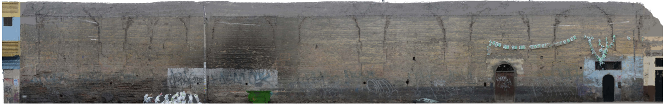
Figura 34. Ortoimagen, elevación, estado actual con lesiones del muro, antiguo Convento de San Francisco Fuente: Elaborado por el autor.
