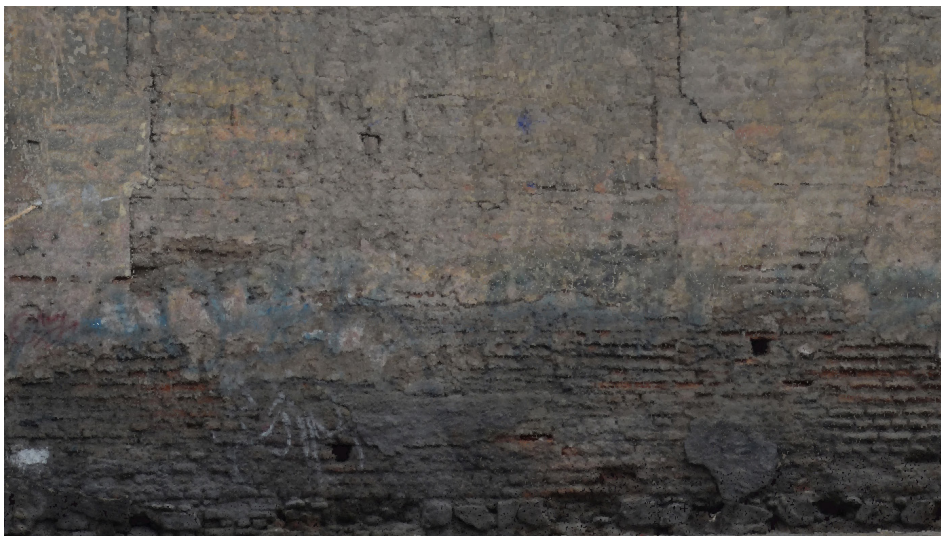
Figura 36. Ortoimagen, elevación, detalle de lesiones del muro, antiguo Convento de San Francisco Fuente: Elaborado por el autor.
