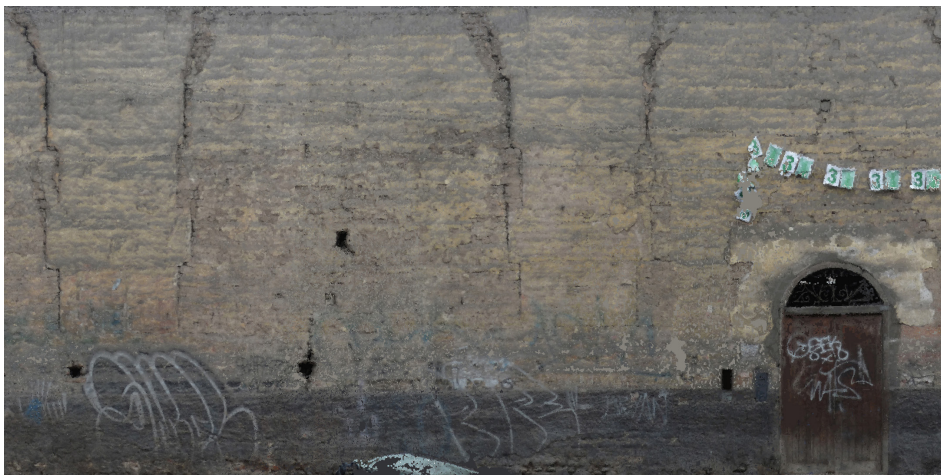
Figura 35. Ortoimagen elevación, detalle de lesiones del muro, antiguo Convento de San Francisco Fuente: Elaborado por el autor.
