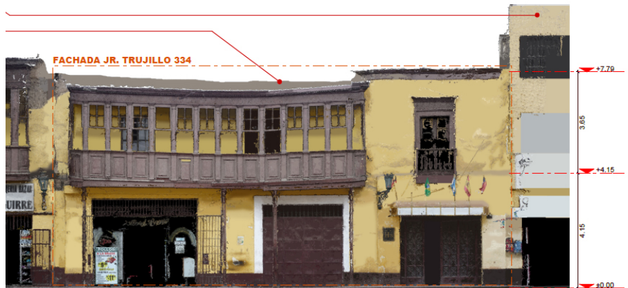
Figura 44. Ortoimagen, levantamiento de estado actual con lesiones, fachada de la Casona Jr. Trujillo Fuente: Elaborado por el autor.
