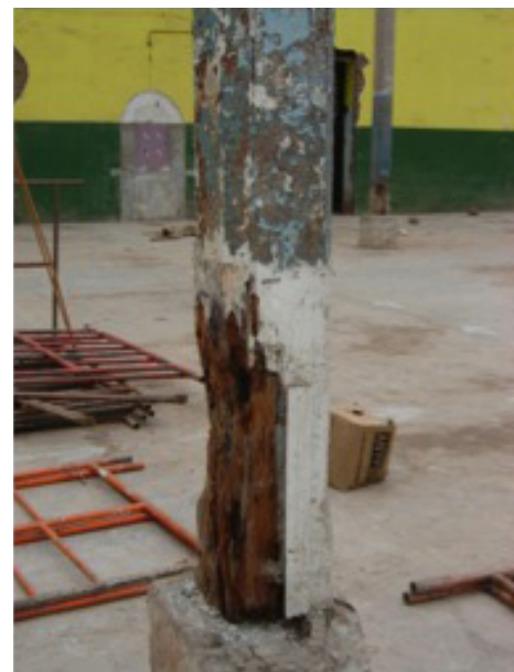
Figura 12. Columna corroída por falta de mantenimiento.
