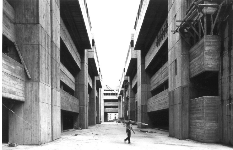
Figura 2. Construcción de una calle interior del Centro Cívico y Comercial de Lima.
