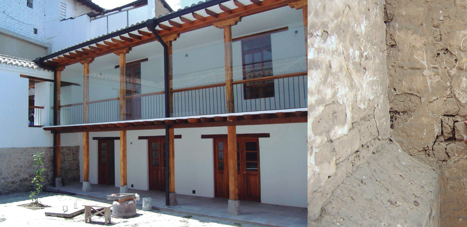
Figura 17. Detalle de la protección de la galería del segundo nivel con cristal templado en la restauración de la casa en la Calle Juan Pío Montufar esquina Eugenio Espejo, Quito, 2006. Fotografía por Héctor Abarca.
