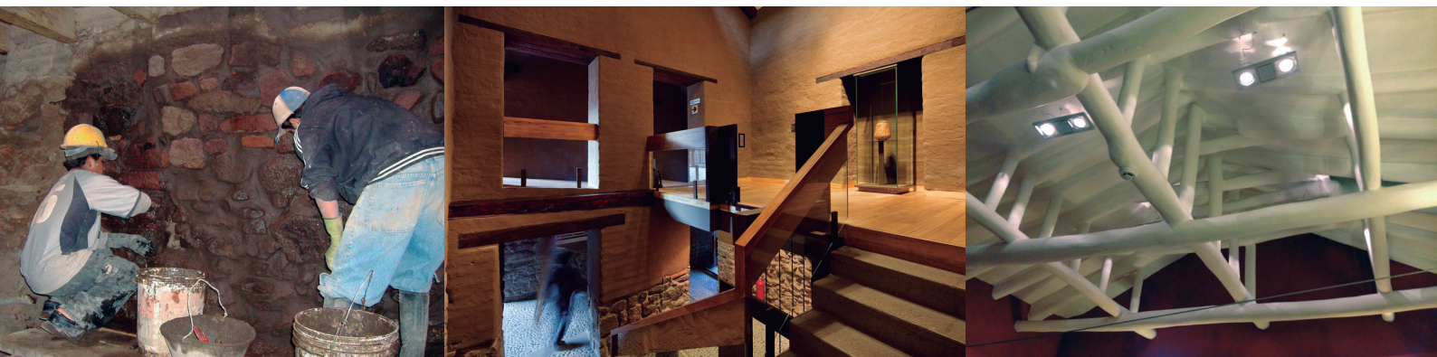
Figura 8. Solaqueo con barro de un muro de piedra. Restauración de una Casa del Alabado (s. XVII), Quito, 2006. Fotografía por Héctor Abarca.
