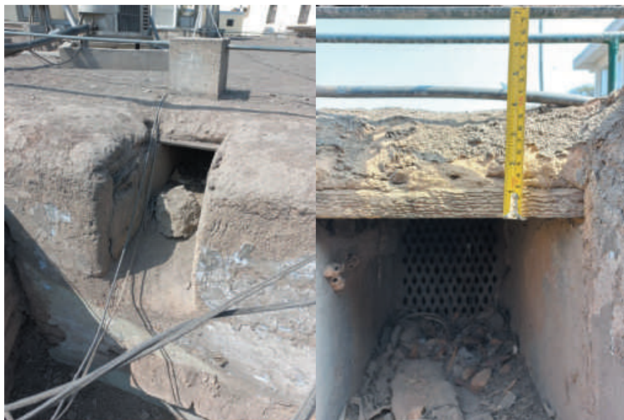
Figura 16. Detalle de la toma de aire fresco en los muros laterales
