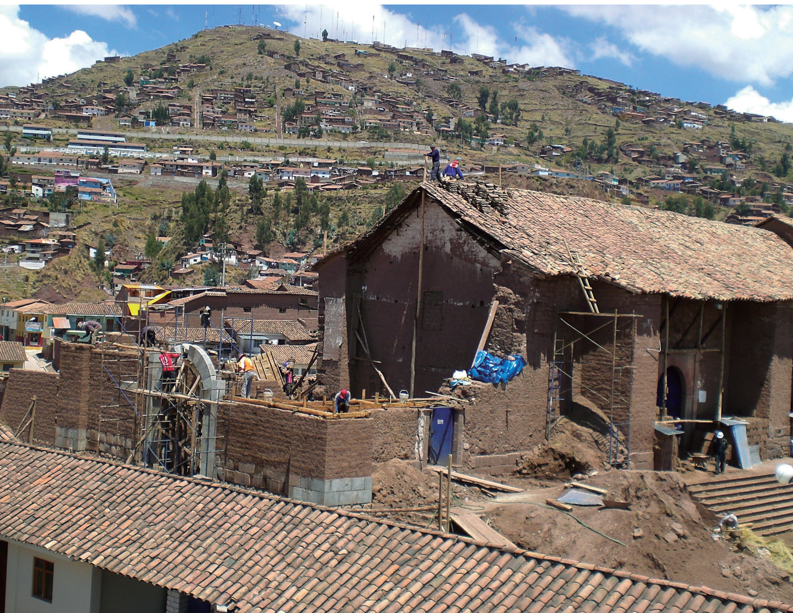
Figura 13. Vista del sector del muro de pies. Se observan los trabajos de reconstrucción del coro y sotocoro, y la portada de pies.
